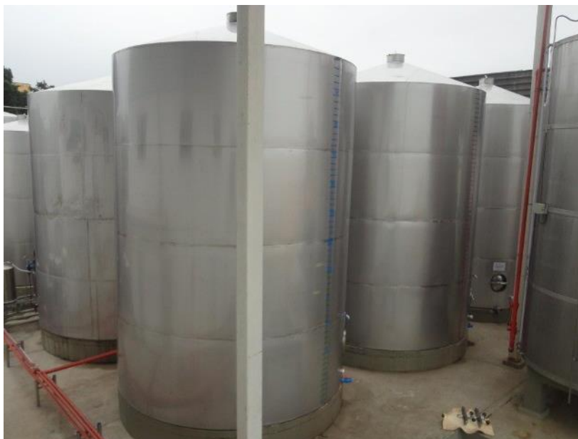
Figura 19 - Modelo de tanques estacionários [Domínio público]
